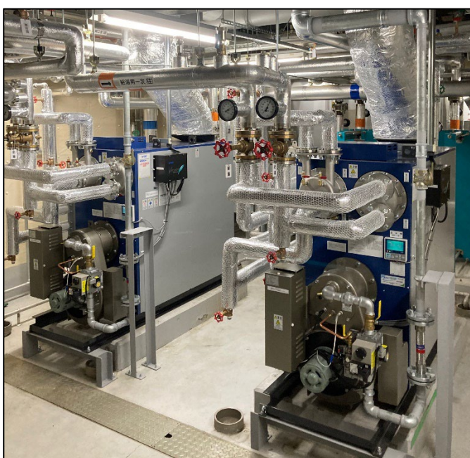
真空式温水ボイラー（都市ガス）
