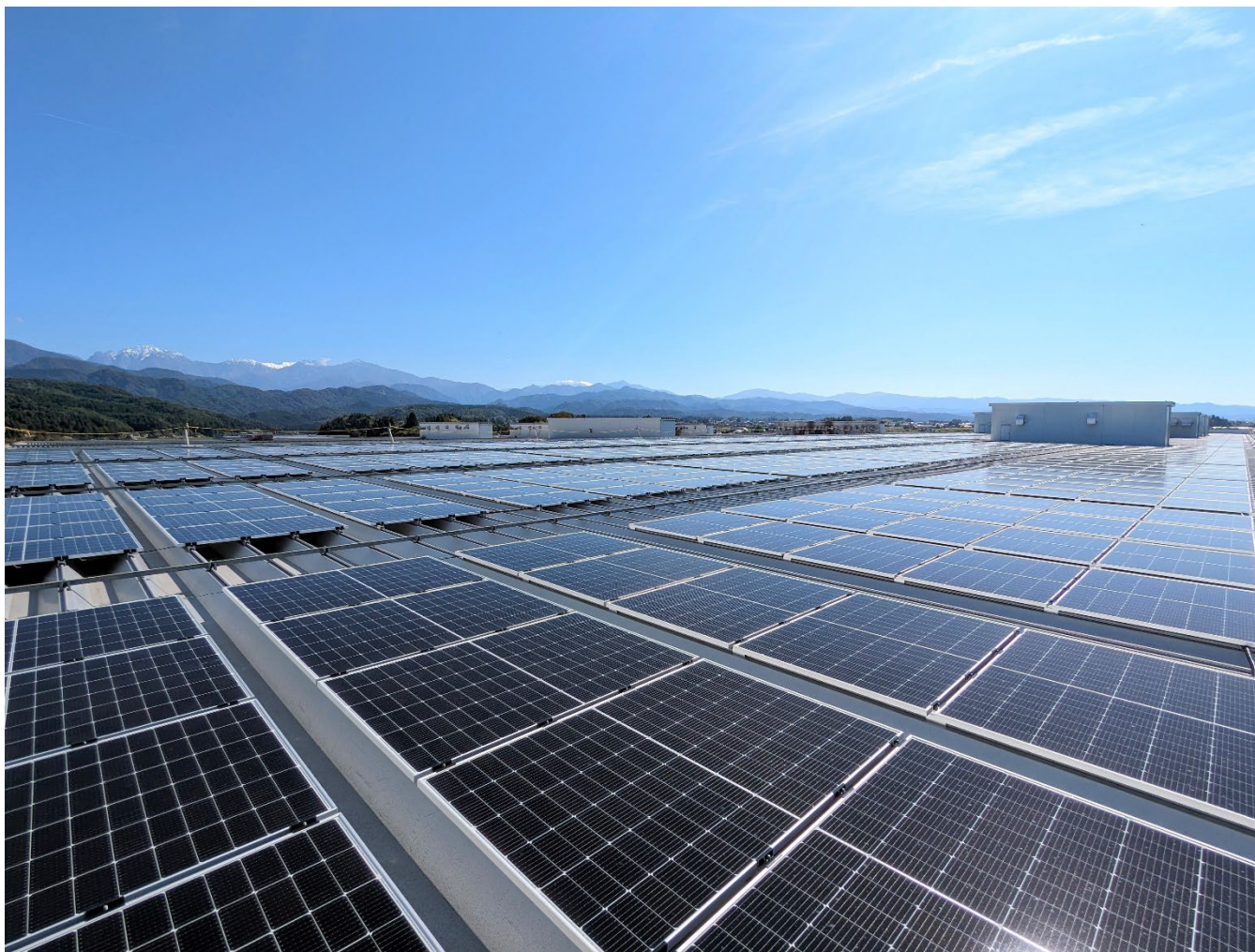
自家消費型太陽光発電システム
