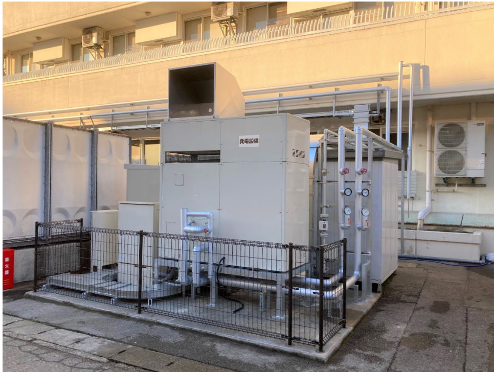
停電対応型ガスコージェネレーションシステム
